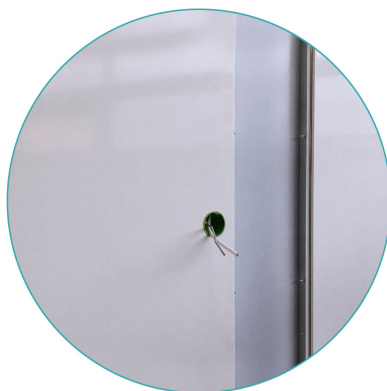
Odkrytý inštalačný stĺpik a elektroinštalácia
