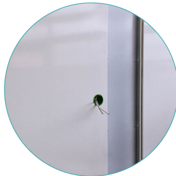
Открытая установочная панель и провода
